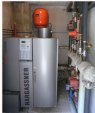
Chaudière bois granulés
